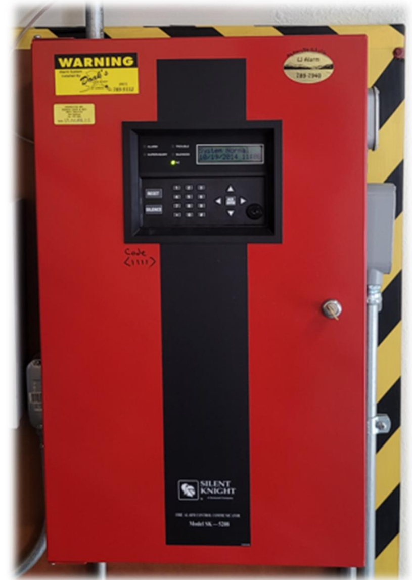
Current Alarm Dialer to LJ Alarms
